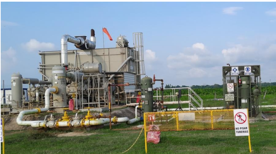
Figura 3. Motocompresores utilizados para las líneas de retorno.
