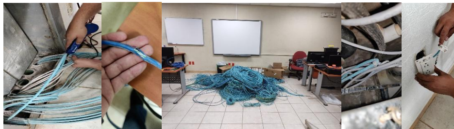
(Figura 4. Cable de red infringiéndola norma ANSI-EIA-TIA 568b y 606– Autoría propia.)
