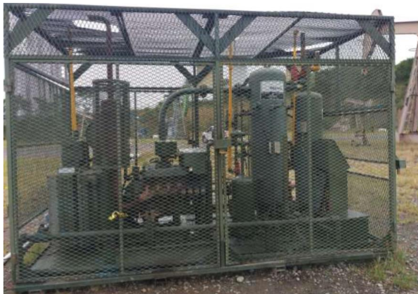
Figura 7 Motocompresor Gas Jack Lift (propiedad compañía de outsourcing).
